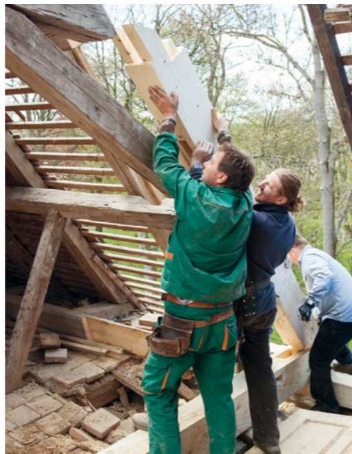
▲ Náhrada poškozených částí krovu při použití tradičních celodřevěných spojů na zámku Brtnice. Foto Viktor Mašát
